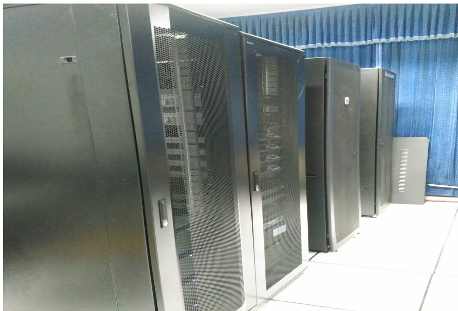
主机房服务器群、存储池
